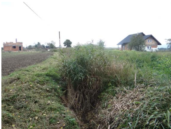
Ryc. 259. Zarośnięty rów melioracyjny – ograniczona przepustowość rowu
